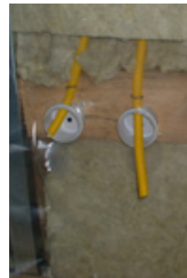
Elektroinstalacija vođena u sloju toplinske izolacije
