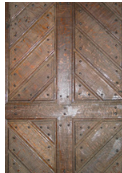
Detalj tradicijskih vrata od hrastovine s kovanim čavlima. Daščice su postavljene dijagonalno na ukrutni križ
