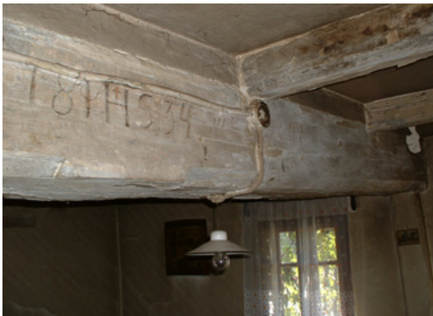
Razvod elektroinstalacije u tradicijskoj kući izveden vidljivim „Bergman” cijevima s žaruljom ispod limenog tanjurastog „širma”
